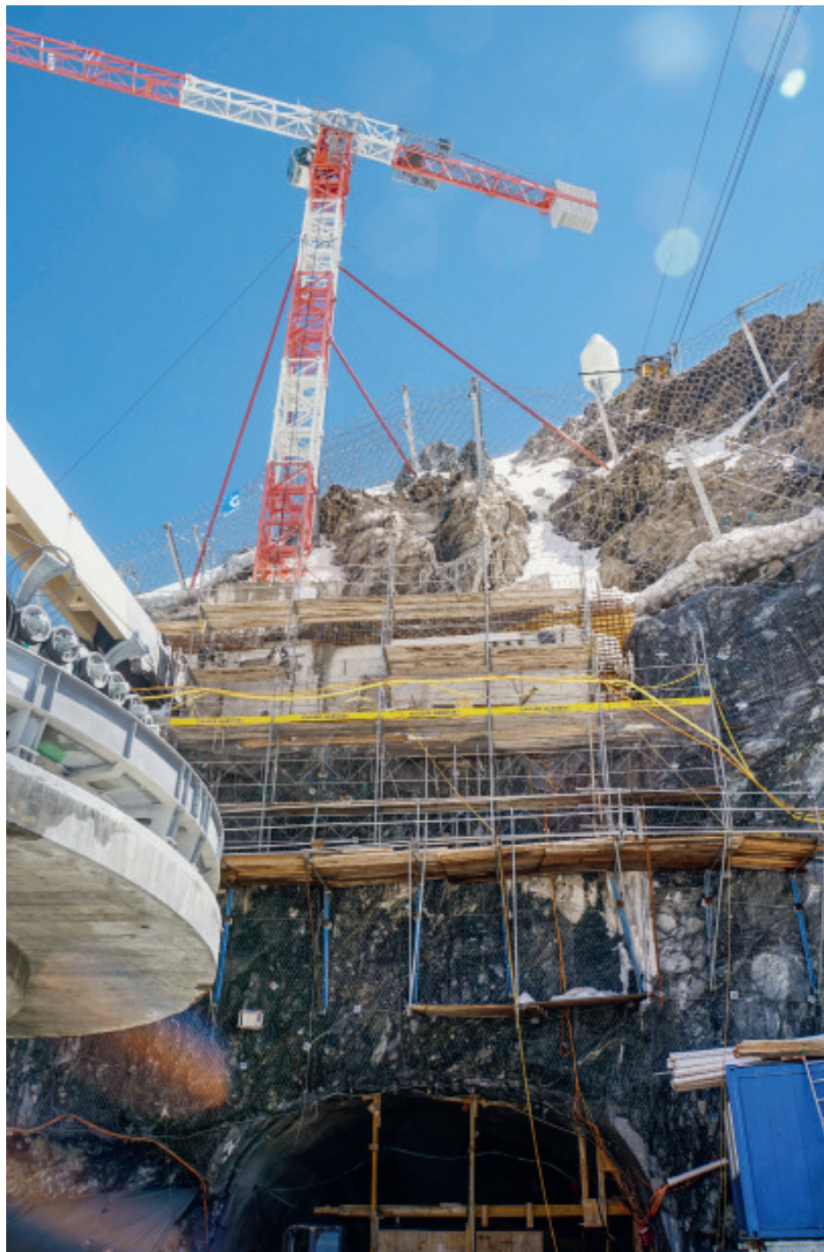
Die Bergstation befindet sich auf der Ebene der Zugangspassage zur bestehenden Pendelbahn, zu der eine Galerie führt (unten). Oben rechts ist der Ankerpunkt der Materialseilbahn zu sehen und links die Umlenkvorrichtung der neuen 3S-Bahn. Der gesamte Bereich ist mit Stahlnetzen gesichert.
