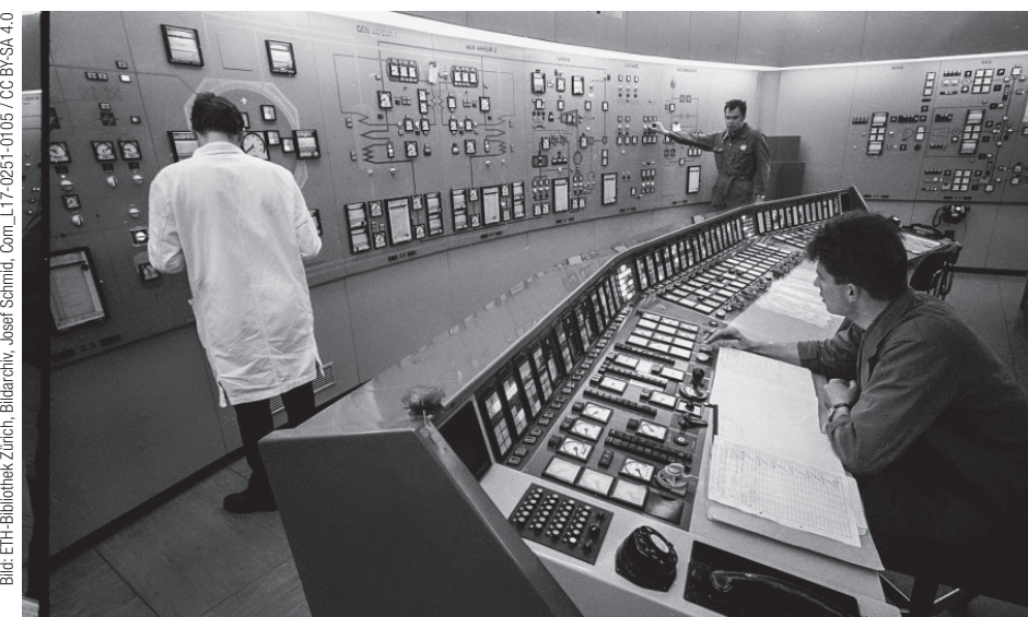
Der Kontrollraum des Versuchsatomkraftwerks Lucens (1968).
