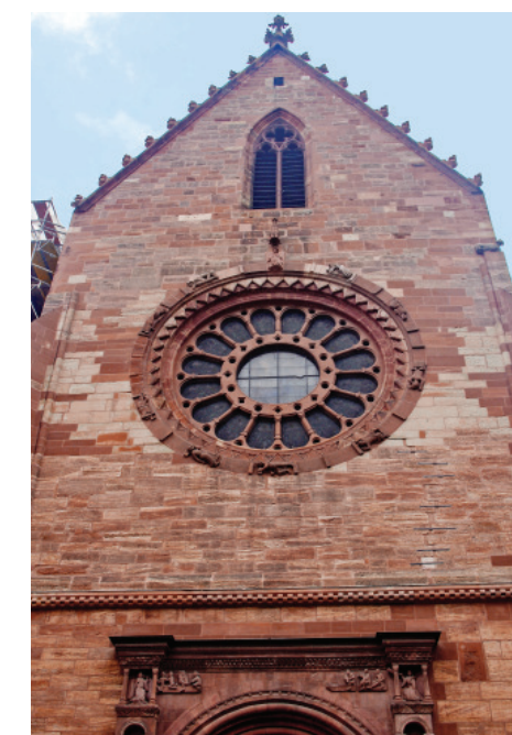
Der Riss zwischen Galluspforte und Glücksrad wurde mit Eisenklammern gesichert.
