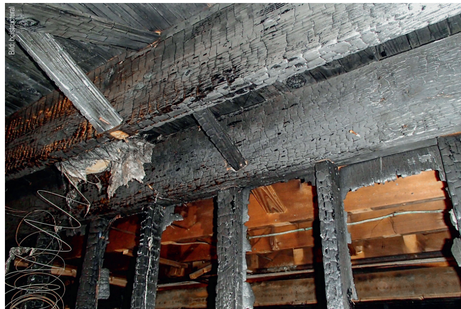
Ausgebrannte Holzstruktur nach dem Löschen eines Brandes: Gerade bei Feuer ist es oft schwierig zu eruieren, ob bauliche Mängel vorlagen und ob der Brandschutz im Gebäude ausreichend war.
