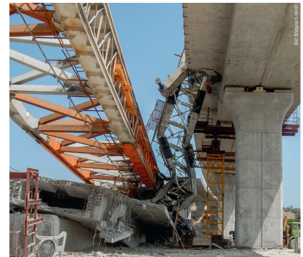
Einsturz einer Autobahnbrücke in Panama: Gerade bei ungenügender Dokumentierung von Bauweise und Berechnungen sind die forensische Kenntnisse von Architekten und Ingenieuren gefragt.
