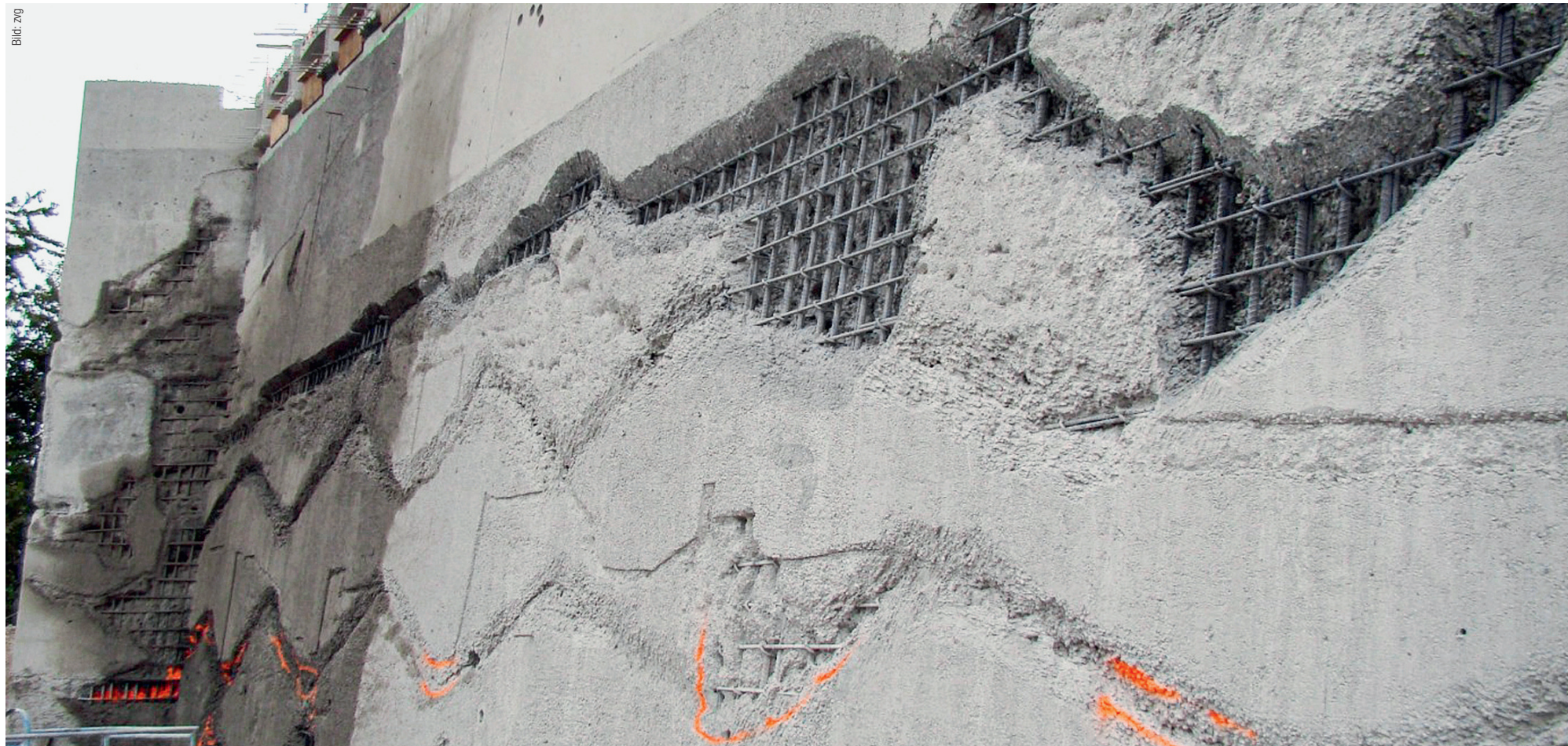
Massive Schäden und Abplatzungen an einer bewehrten Betonmauer: Um die Ursache zu ermitteln und die Frage des Schadenersatzes zu klären, ist oft Detektivarbeit gefragt.
