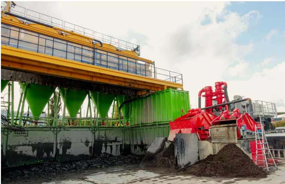
In der Aufbereitungsanlage durchläuft das Material mehrere Siebe, die grobe Verschmutzungen, organische Bestandteile sowie Sand trennen. Nach der anschliessenden Entwässerung gelangt das Restmaterial in die gelbe Kammerpresse.
