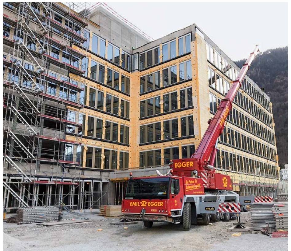
Montage der Fassadenisolation: «Sinergia» ist an ein Energienetz angeschlossen und wird trotz der strengen Bündner Winter verhältnismässig wenig Heizenergie benötigen.
