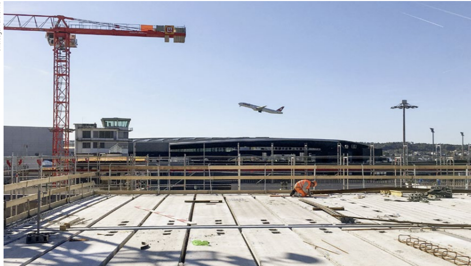
Nach der Montage der vorfabrizierten Deckenelemente ist der Rohbau für das nächste Stockwerk des GSA fertig. Dank modularer Bauweise wird der enge Zeitplan für den Hochbau eingehalten.
