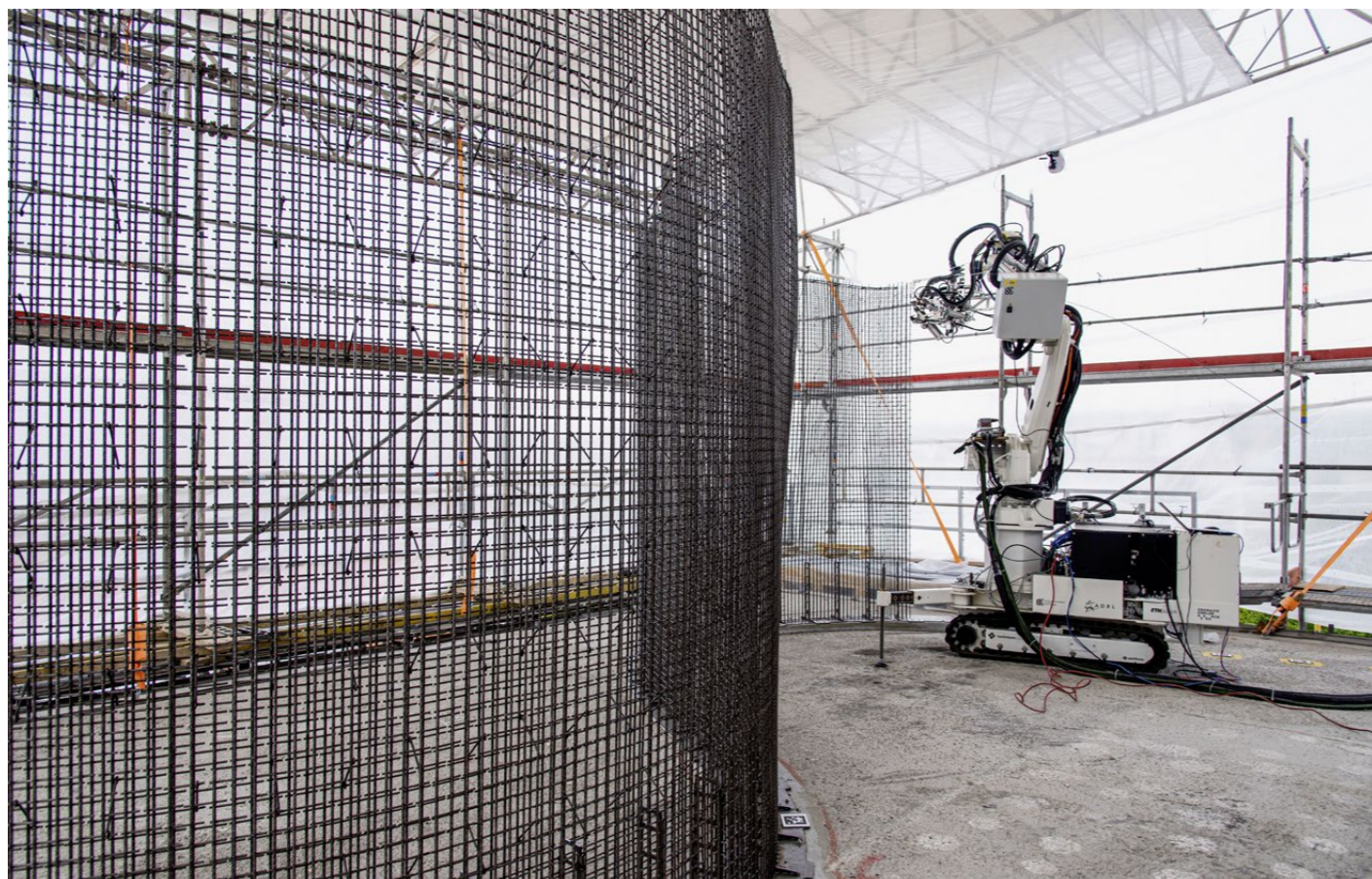
«DFAB House» auf dem Nest-Gebäude in Dübendorf: Für den Einbau der Bewehrung war ein stationärer Armierungsroboter im Einsatz.
