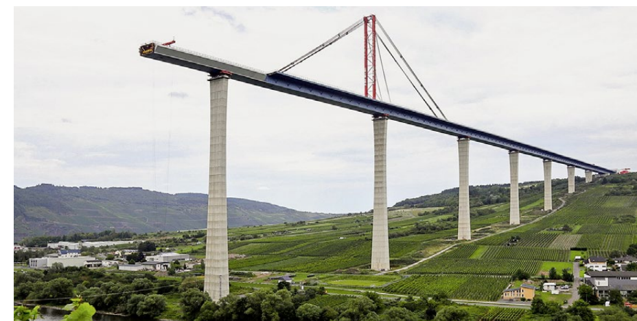
In der zehnten Vorschubphase erreichte die neue Brücke ihren tiefsten Punkt, den Pfeiler unmittelbar am Moselufer. Auch dieser steht am Ostufer der Mosel.
