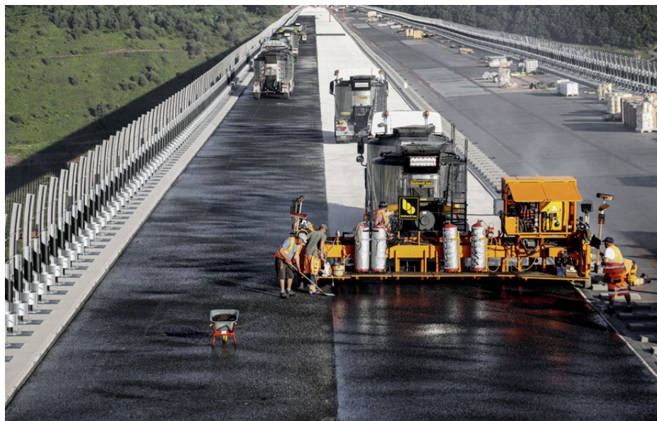
Der eigentliche Strassenbau wie hier etwa das Einbringen des Gussasphalts erfolgte im Sommer 2019.
