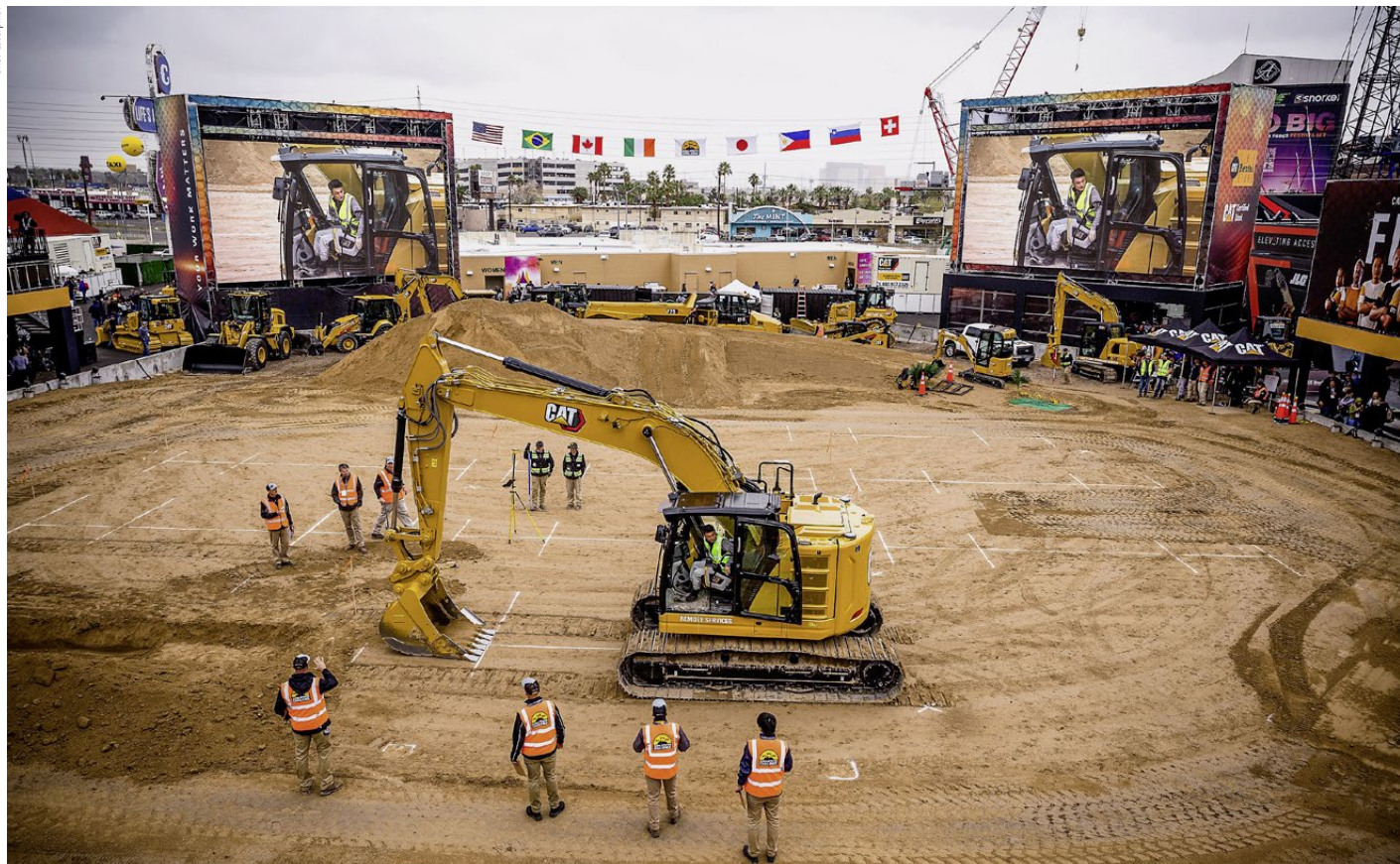
Blick in das extra für die Challenge gebaute Cat Operator-Stadion auf dem Messeareal der Conexpo 2020 in Las Vegas: Mit dem Hydraulikbagger musste ein präzises Planum erstellt werden. Kritisch wurden Arbeitsweise und Ausführung beobachtet.
