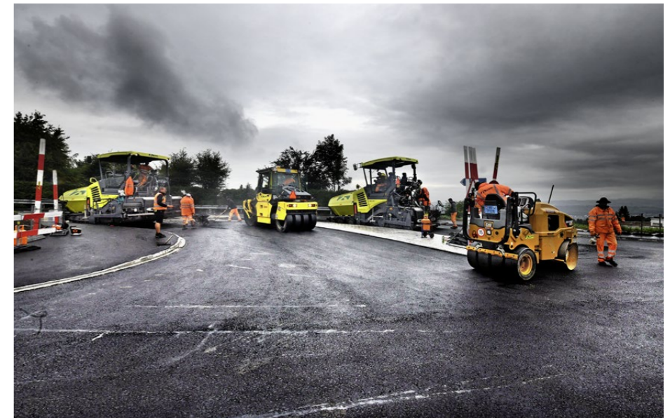
Manchmal ist nicht nur der einzubauende Belag schwarz: Strassenbau findet draussen statt – und dies bei jedem Wetter.
