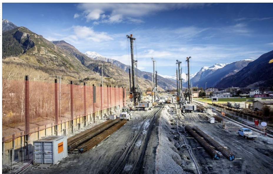
Eindrückliches Bild: In Raron sind die vier grössten, modernsten und leistungsfähigsten Grossbohrgeräte der Schweiz im Einsatz.
