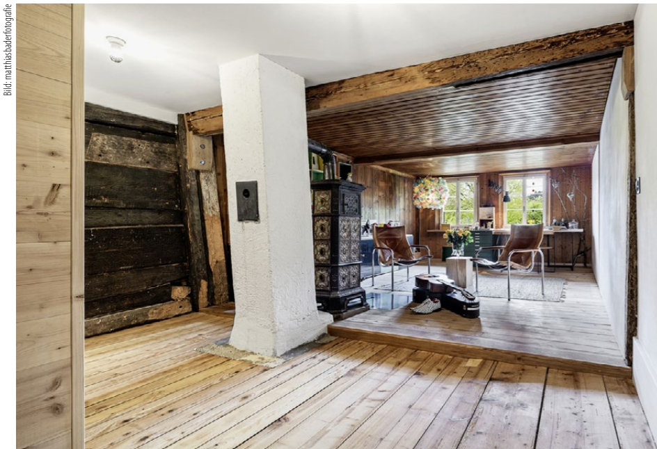
Nach dem Abbruch einer Zwischenwand kann natürliches Licht den mittigen Raum des Flarzhauses im Zürcher Oberland aus dem Jahr 1738 fluten.
