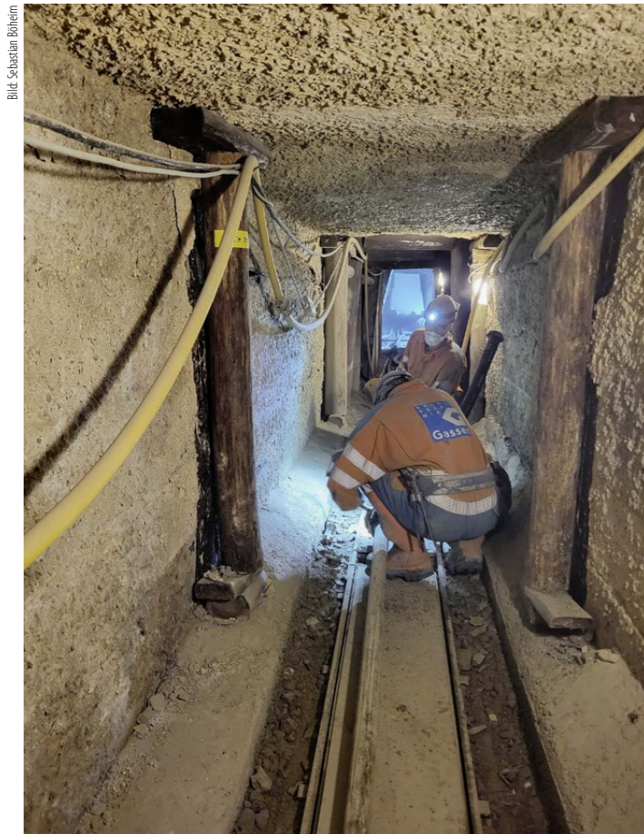
Der enge und niedrige Stollen erschwerte das Arbeiten erheblich. Hier eine der noch vorhandenen und kontrollierten Engstellen.
