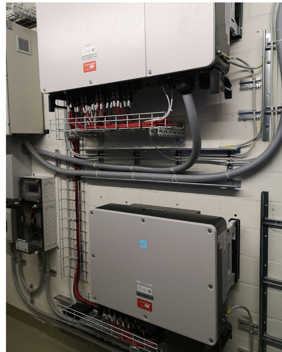
Hier wird aus Gleichstrom der PV-Anlage Wechselstrom für den Eigenverbrauch im Gebäude und die Einspeisung ins Netz gemacht.
