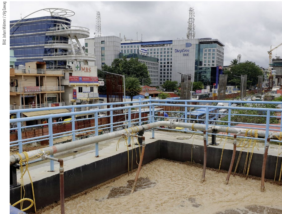
Dezentrale Wasserwiederverwendungsanlage in einem Krankenhaus in Bengaluru.
