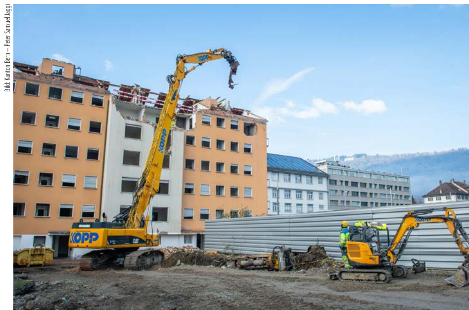
Zum Jahresbeginn konnten die Bauarbeiten beim Campus Biel der Berner Fachhochschule wieder aufgenommen werden. Der Kanton rechnet mit einem Bezug der Gebäude im Jahr 2027.
