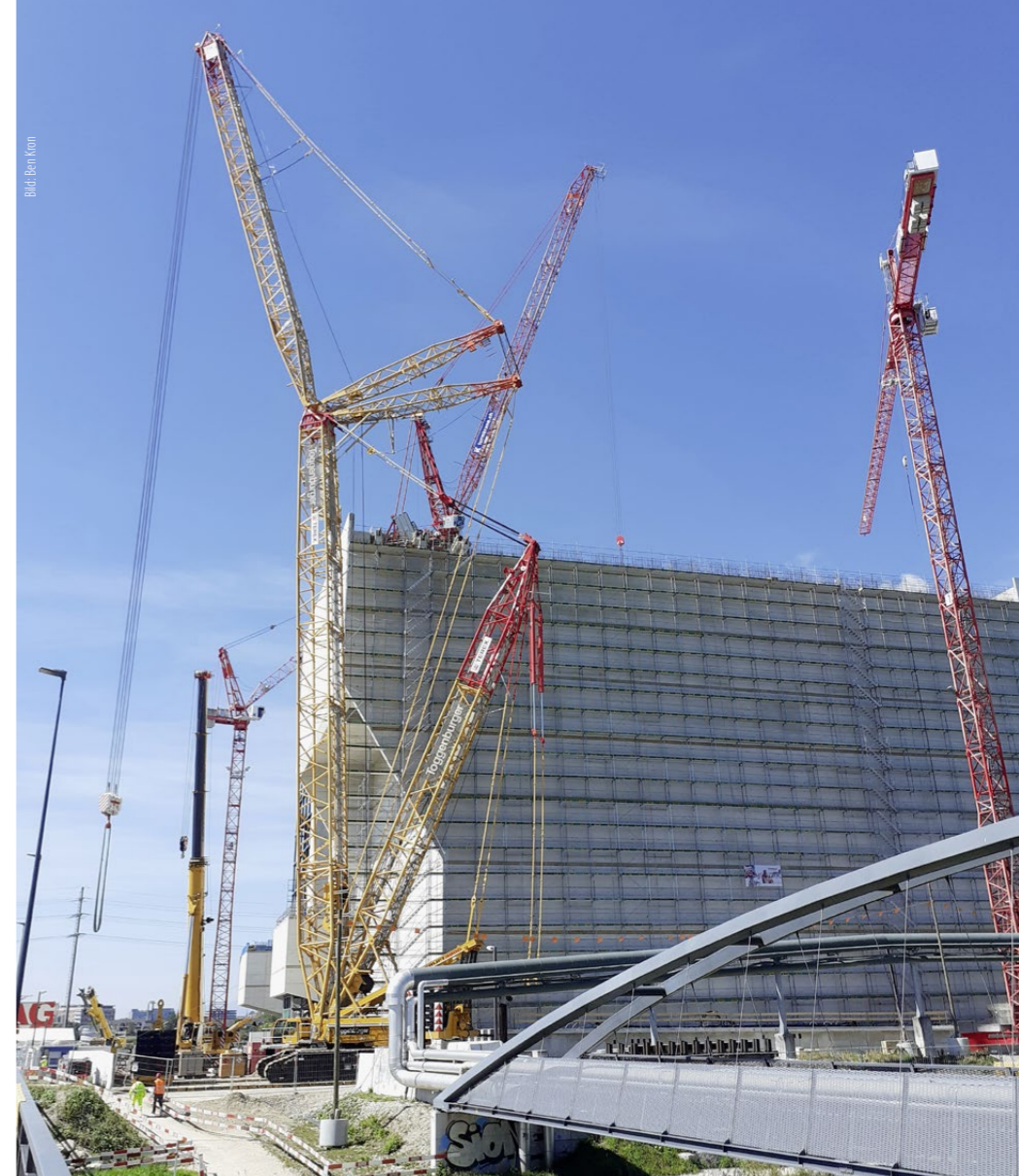
Endspurt beim Grossprojekt: Nächstes Jahr wird die neue Kehrrichtverbrennungsanlage in Zuchwil SO in Betrieb gehen und jährlich 265 000 Tonnen Müll thermisch verwerten.
