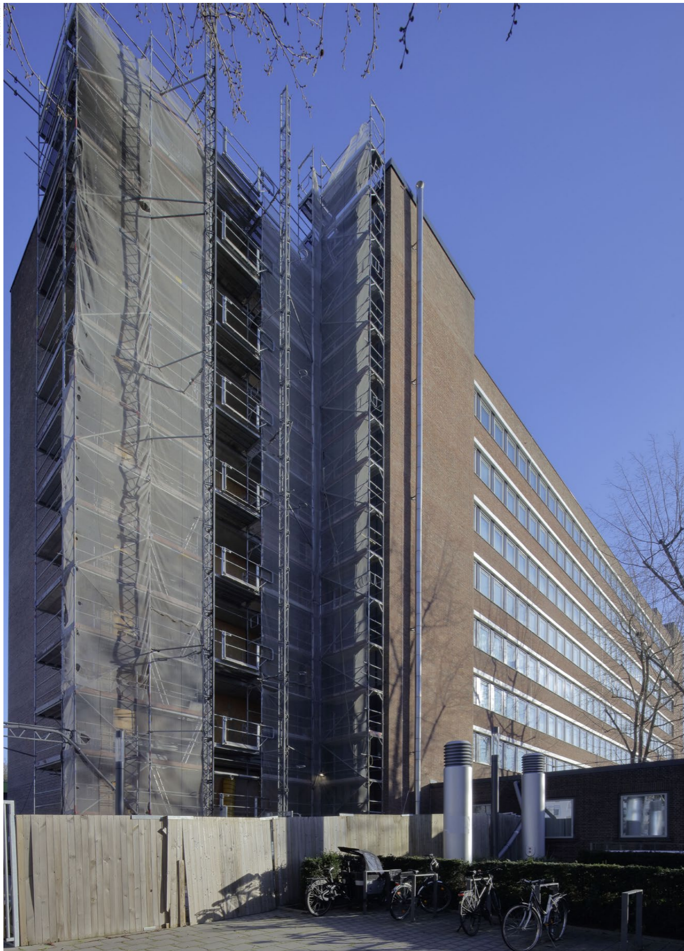
Bei einer früheren Sanierung wurden die Schwingflügelfenster durch Drehklappenfenster aus Aluminium ersetzt. Der ungenügende Wärmeschutz und die schlechte Luftzirkulation führten in den kleinen Einzelbüros in der Folge im Sommer zu hohen Raumtemperaturen.
