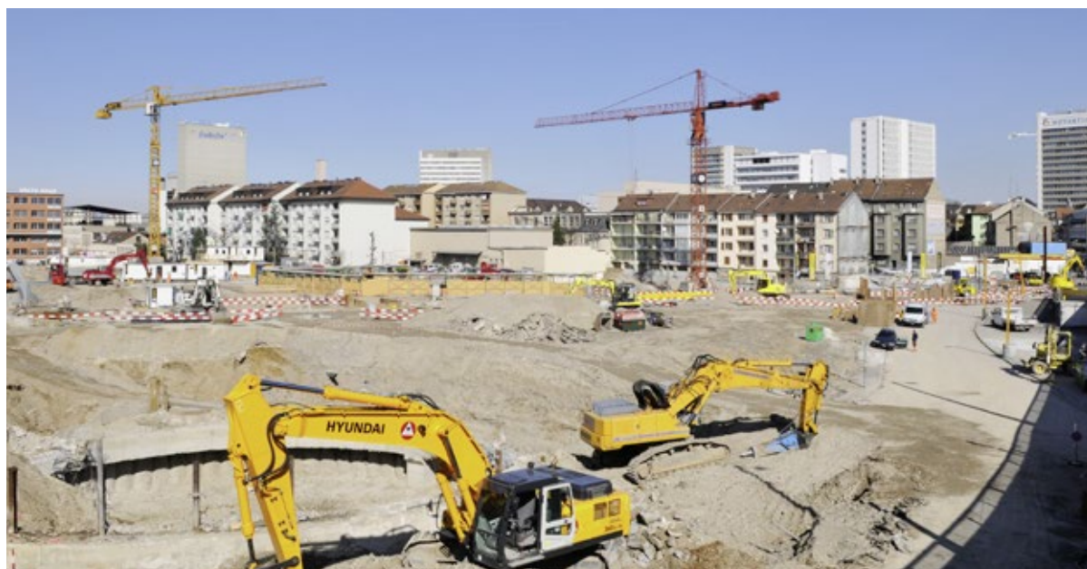
So sah die Baustelle der Nordtangente auf dem Vogesenplatz im März 2008 aus. Im Hintergrund das Firmengelände der Novartis.
