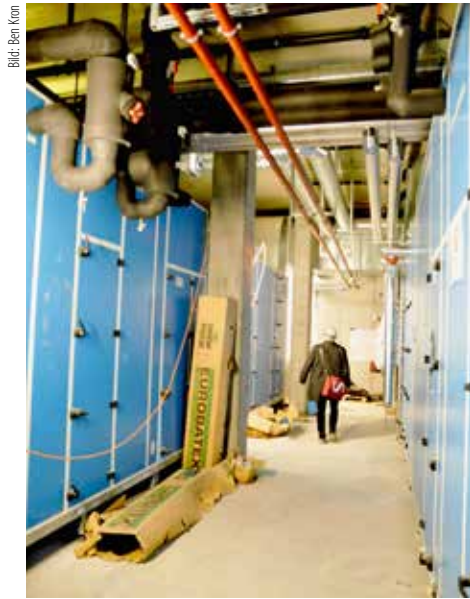
Monoblöcke der Lüftung: Das neue Hallenbad verfügt über eine umfangreiche Haustechnik.
