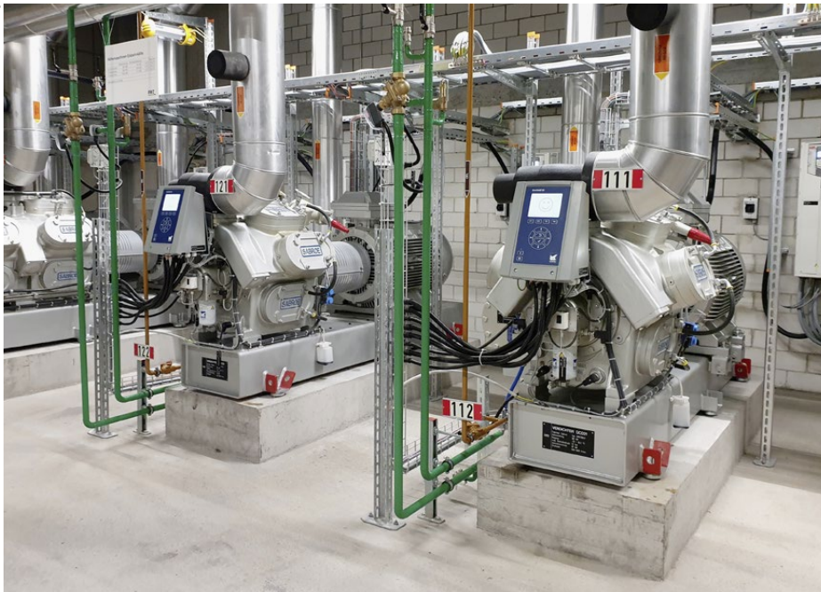
Als Schaltstelle für die Kälte- und Wärmeproduktion dient eine Energiezentrale, die im April 2021 vom Elektrizitätswerk der Stadt Zürich (EWZ) übernommen wurde. Im Bild: Kältemaschinen für die Eisbahn.
