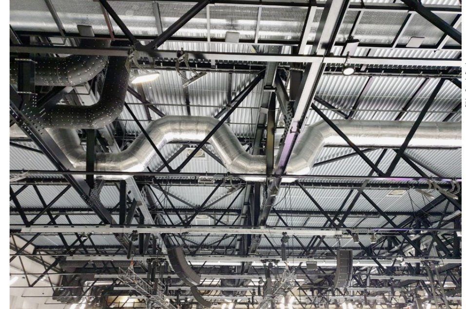
Blick auf die Dachkonstruktion mit den rund 85 Meter langen Stahldachträgern. Experten hatten hier kurz vor Weihnachten 2021 fehlerhafte Schrauben festgestellt. Alle mussten ersetzt werden.
