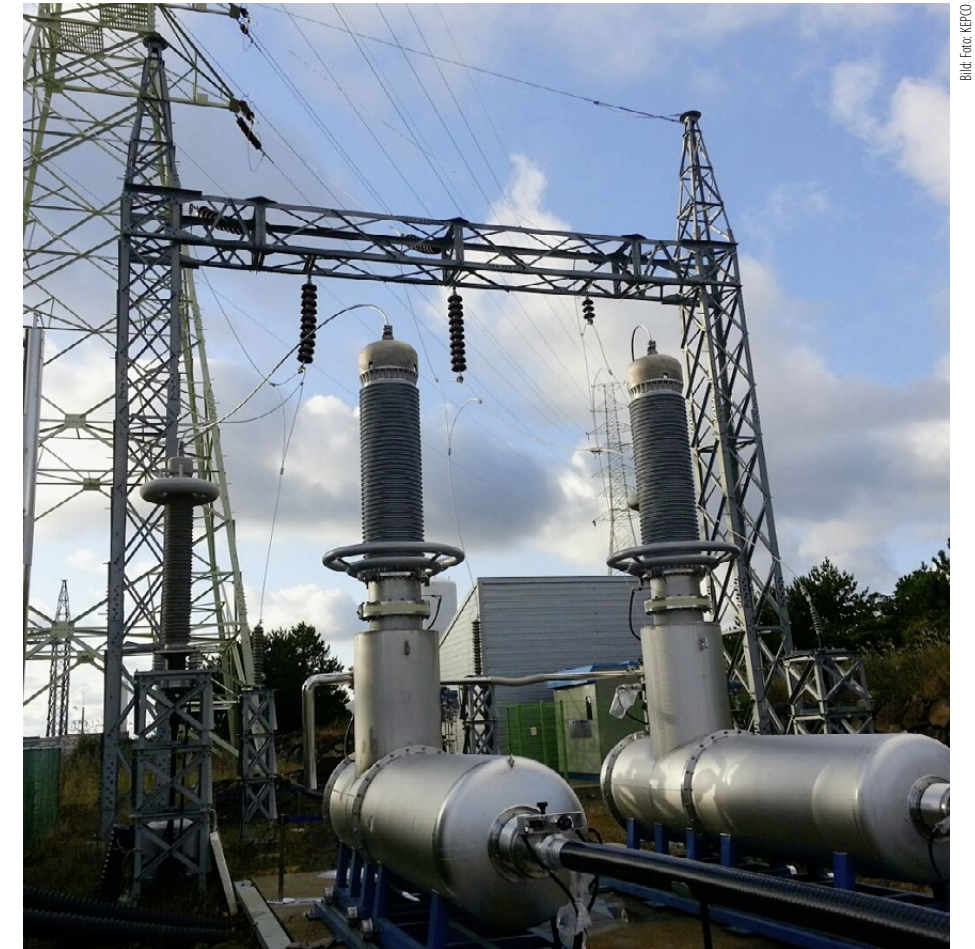
Endpunkt eines supraleitenden Gleichstrom-Kabels mit 80 Kilovolt-Spannung in Südkorea.
