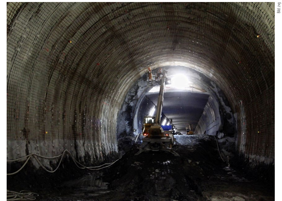
Der Vispertaltunnel wird ins System der A9-Umfahrung von Visp integriert. Auf rund 200 Metern wird in einer geologischen Störungszone zur Verstärkung der bestehenden Verkleidung ein Sohlgewölbe eingezogen.
