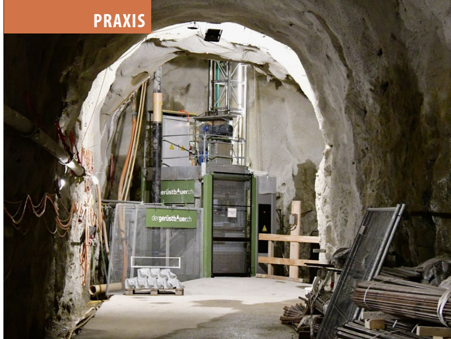
Zugangsstollen an der Basis des Material- und Personellifts.
