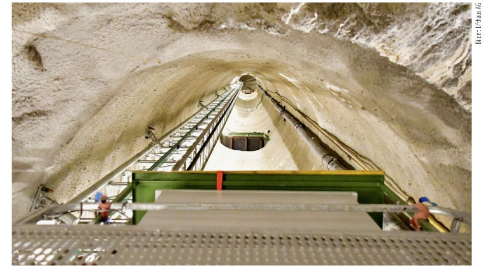
Blick in den Liftschacht zum oberen Ende. Deutlich sind die Zugänge der bereits im Vorfeld erstellten Zugangsstollen zu erkennen.
