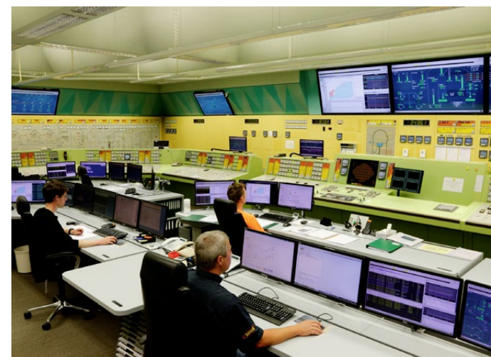
Blick in den Kommandoraum des Kernkraftwerks Leibstadt. Das KKL produziert ein Sechstel des Schweizer Stroms.
