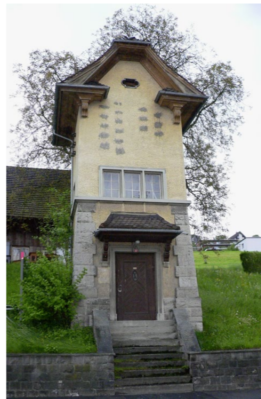
Die Trafostation in Ebikon LU zeichnet sich durch gesprossene Eckpfeiler und ein geschweiftes Satteldach mit Klebedachspickeln aus.
