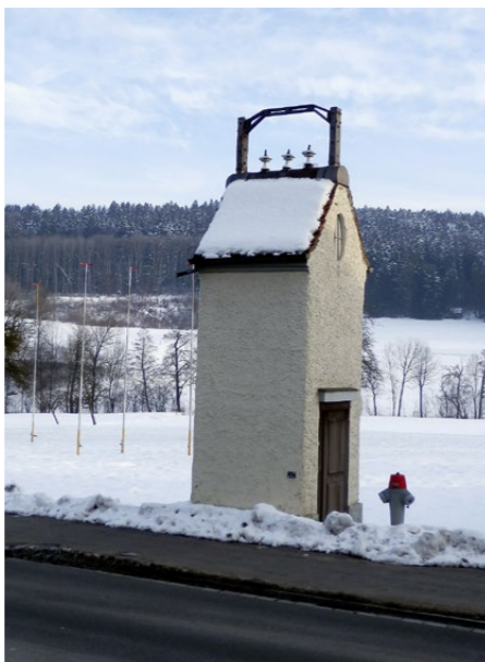
Eine Seltenheit: Beim Trafohaus in Russikon ZH wurde über dem Satteldach ein grosser Eisenbügel mit Aufbauten für die Stromzufuhr angebracht.
