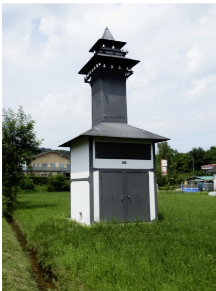
Kabinentrafo in Embrach ZH: Über dem quadratischen Kubus befindet sich ein spitz zulaufendes Türmchen aus Blech, an dessen Ende sich die alten Keramikisolatoren befinden.
