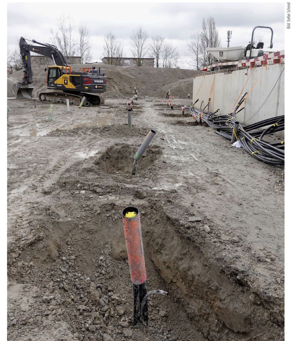
Rund zwei Drittel der Hochtemperatur-Erdsonden befinden sich unter dem Parkhaus. Der Rest ist ins umliegende Gelände abgeteuft. Mit ihrer Forschung erschliesst die Empa auch unbekanntes Terrain.
