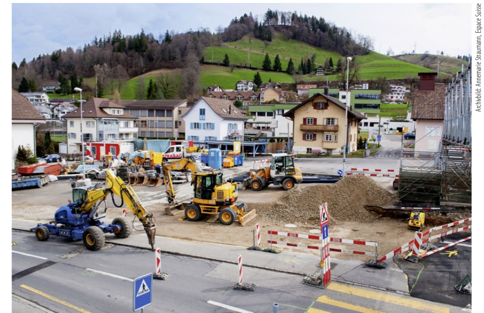
In Entlebuch LU wird das Gebiet um den ehemaligen Marktplatz Schritt für Schritt erneuert.
