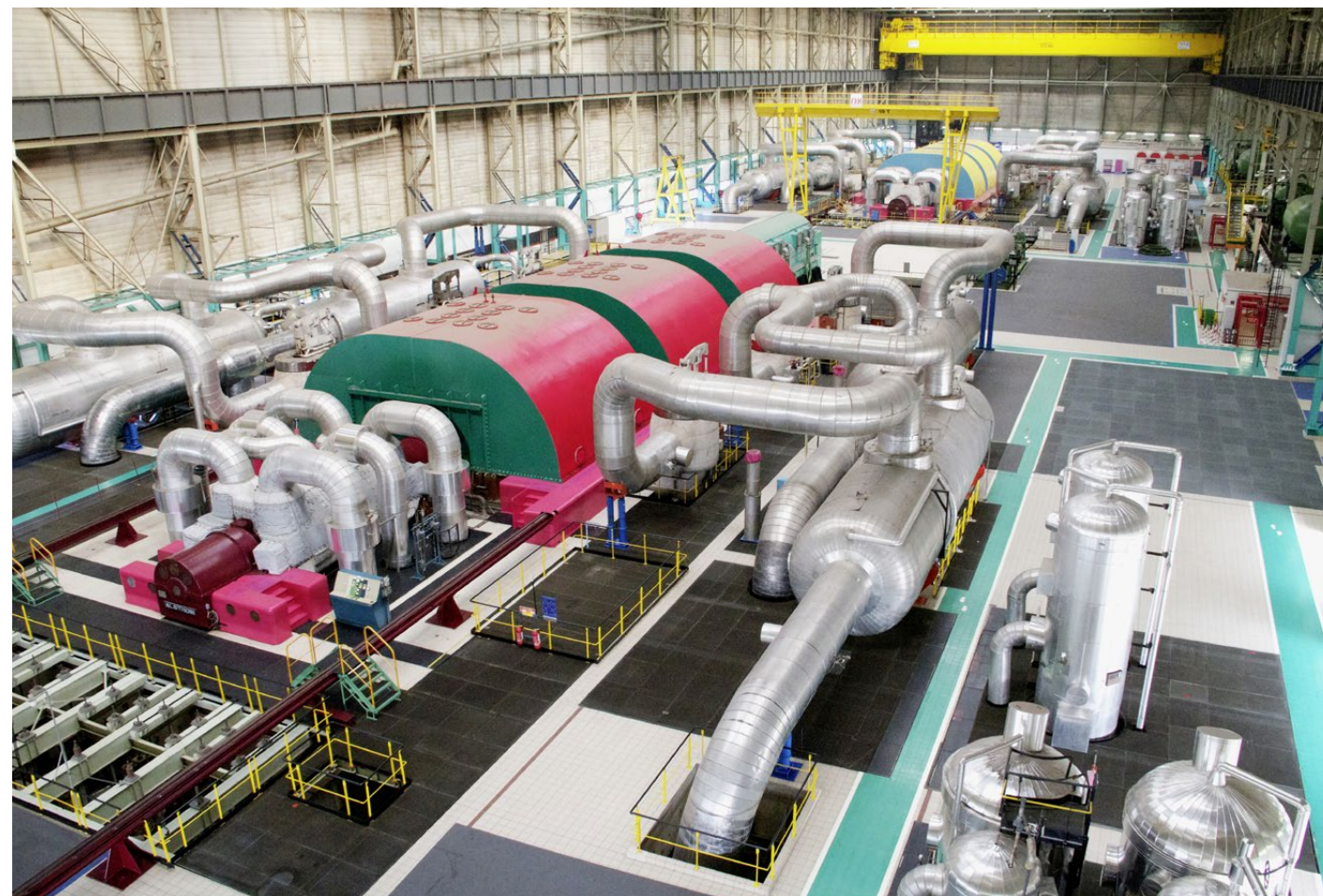
Die EDF plant, manche Komponenten zu sichern und in anderen Kraftwerken als Ersatzteile zu nutzen. Das Bild zeigt die Maschinenhalle des KKW Fessenheim.
