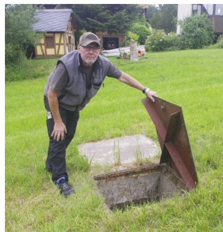
Dieter Kaiser liest auf seiner Inspektionstour eine Wasseruhr ab. Der angrenzende Bauernhof hat nämlich bis heute das Recht, zwei bayerische Mass Wasser pro Minute aus der Leitung zu entnehmen als Entschädigung dafür, dass die Leitung unter seinem Grund verlegt ist.
