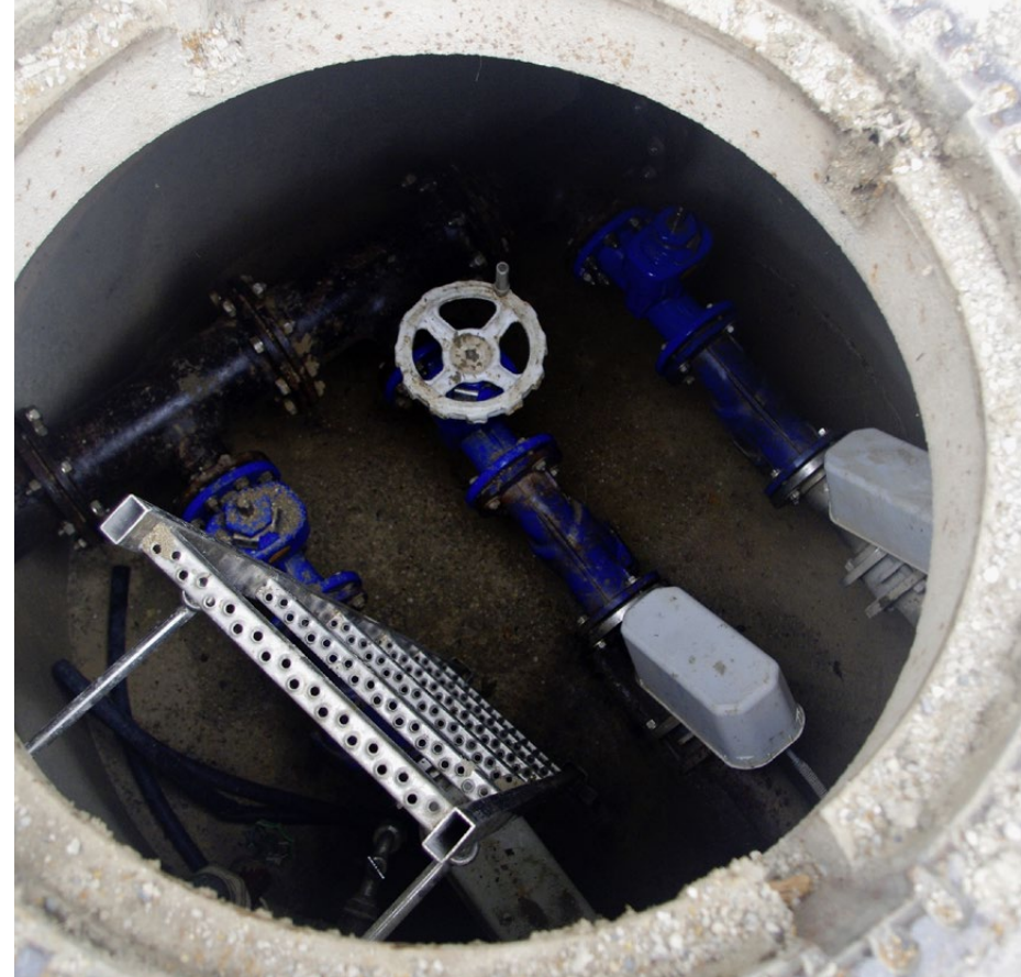
Anders als seine Vorgänger muss der Wassermeister nicht mehr pünktlich an den Schiebern stehen, wenn das Publikum sich jeweils zur vollen Stunde vor den Wasserspielen versammelt. Ein Zugeständnis an die Moderne sind Magnetschieber, die eine Zeitschaltuhr automatisch auslöst.
