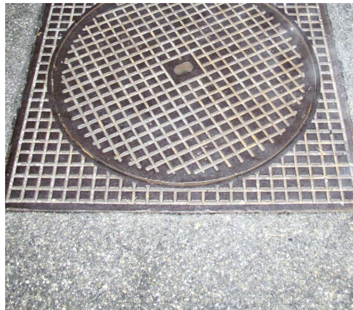
Bild: Stefan Schmid Auch Schachtabdeckungen können die Wirkung von lärmarmen Belägen beeinträchtigen.
