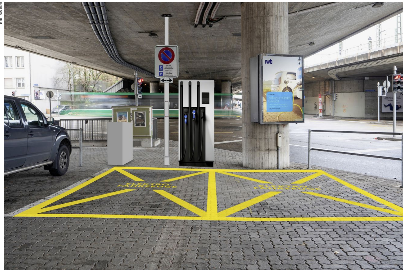
Eine der Schnellladestationen für Elektroautos befindet sich in Basel unter der Autobahn am Museum Tinguely.
