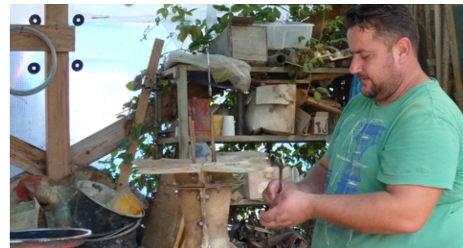
Jimmy Kryeziu arbeitete bereits mit Bruno Weber zusammen. Er beherrscht alle Techniken zur Herstellung und Sanierung der Plastiken. In der Schalung entsteht hier in der Werkstatt ein neuer Vinzi.
