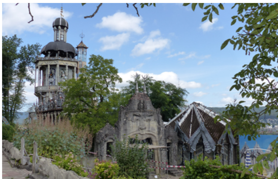
Oberhalb von Spreitenbach liegt der Bruno-Weber-Park auf einem 15 000 Quadratmeter grossen Areal. Der Zahn der Zeit nagt an vielen Bauten und Skulpturen. Eine Sanierung ist dringend notwendig.
