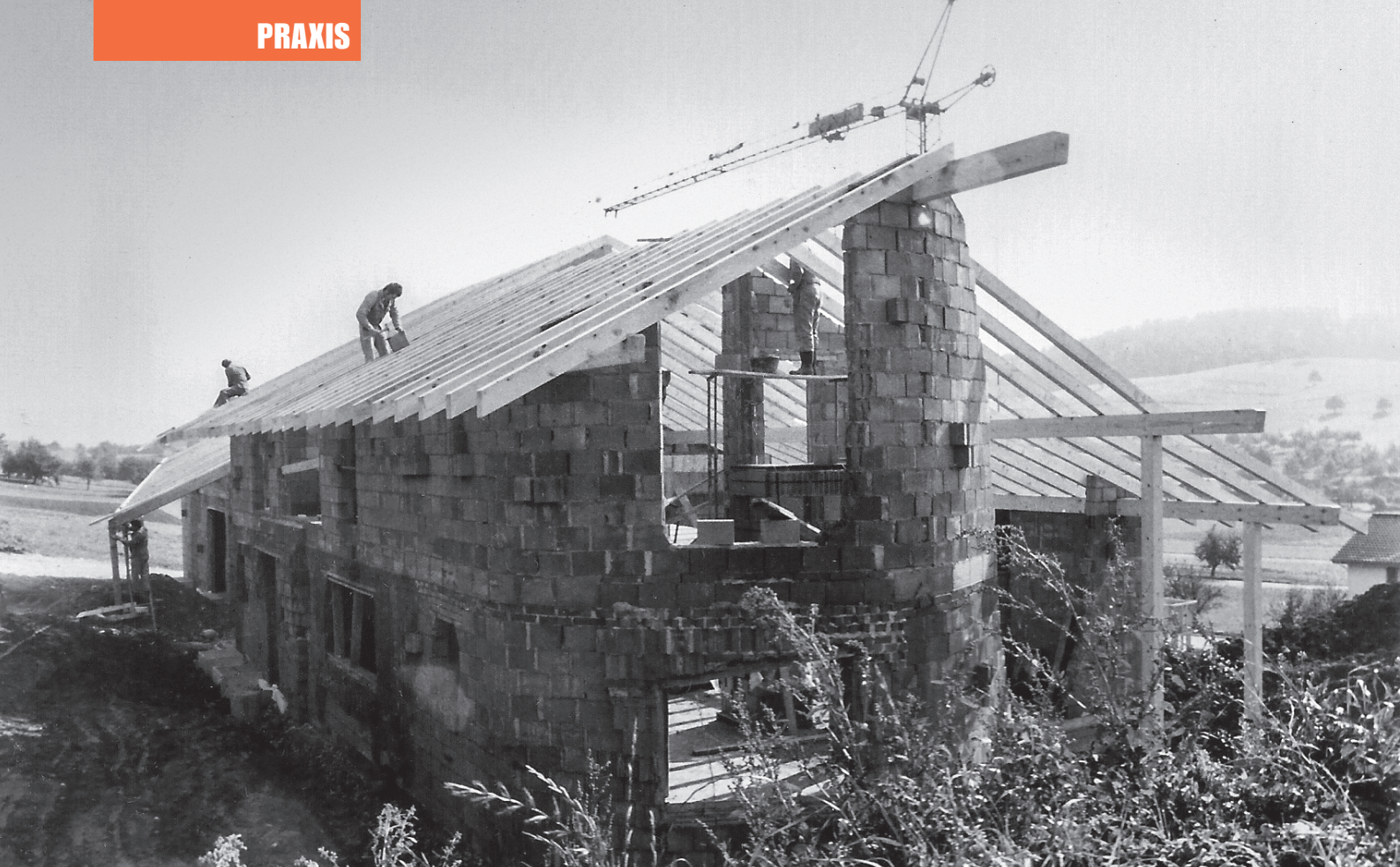
Dieses Bild vom Bau des Arzthauses Golder in Seftigen zwischen 1974 und 1976 zeigt, was Stalder unter krummen Mauern versteht.
