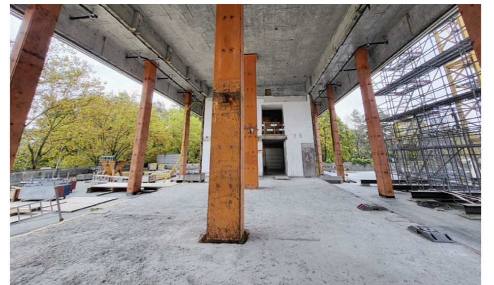
Der Eingangsbereich des Hochhauses in Ostermündigen wird für die Umnutzung zu einer hellen, grosszügigen Lobby erweitert.
