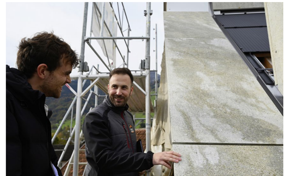
Architekt Ronan Crippa (links) bespricht mit Marc Vetsch die Endmontage der Traufsteine.
