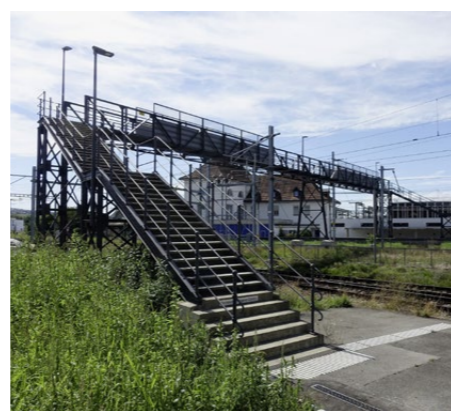
Die Passerelle wurde leicht angehoben und mit Stufensokkeln versehen. Schilder weisen darauf hin, dass die Besteigung auf eigene Gefahr erfolgt, denn Absturzsicherungen entsprechen nicht überall den aktuellen Normen.
