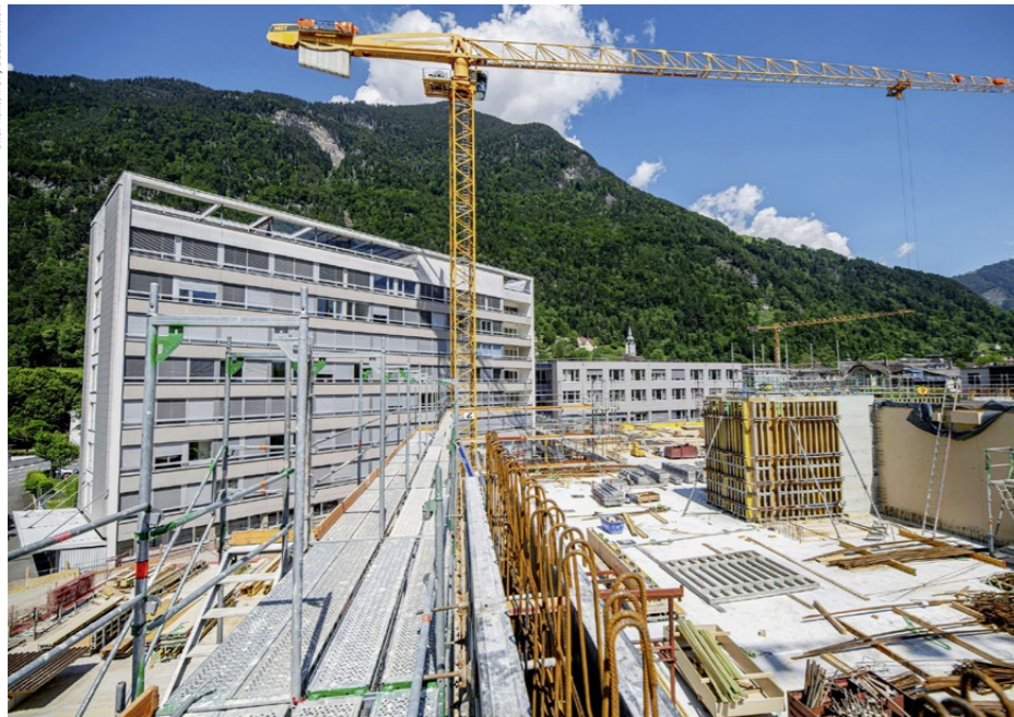
Eine Aufnahme von 2020: Hier war das neue Kantonsspital Uri noch im Bau. Links hinten ist das alte Gebäude zu sehen, das dieses Jahr nun wie geplant rückgebaut werden kann.
