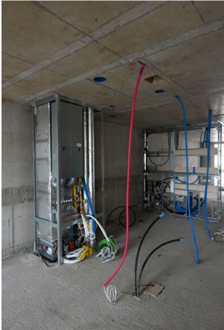
Ein neues Gebäudetechnikmodul (vorne) und ein GIS-Modul (hinten).
