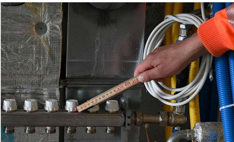
Die Module enthalten alle nötigen Komponenten für den Anschluss der integrierten Gewerke, so etwa den Bodenheizungsverteiler.
