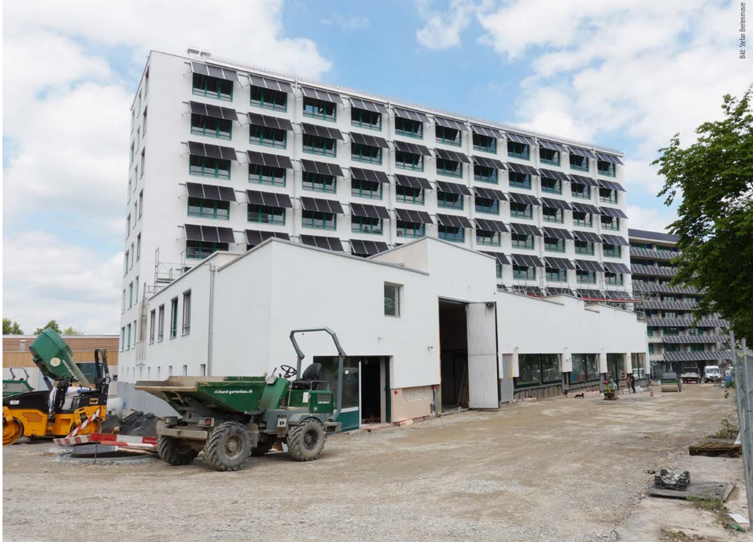
Boomender Wohnungsmarkt: Auf dem Areal Guggach in Zürich erstellt die Stiftung Einfach Wohnen zurzeit 111 gemeinnützige Wohnungen mit in der Fassade integrierter PV-Anlage.
