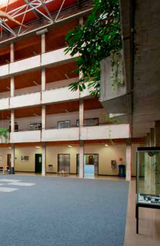
Die Schulanlage Bäumlihof war augenscheinlich ein Fall für die Abrissbirne. Erst intensive Studien zeigten, dass eine Sanierung doch wirtschaftlicher war.
