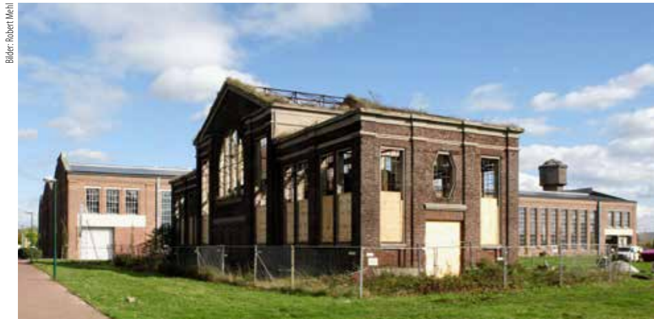
Das Gebäude vor der Sanierung. Das Mauerwerk war mittlerweile marode.
