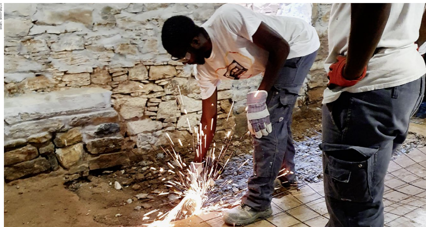
Ein Armierungsnetz wird auf die benötigte Grösse zugeschnitten, um dann den Beton einzubringen.
