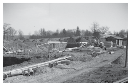
Die Entwässerung des Baugrundes durch die Trockenlegung von Bächen stellen 1946 die ersten Arbeiten dar.
