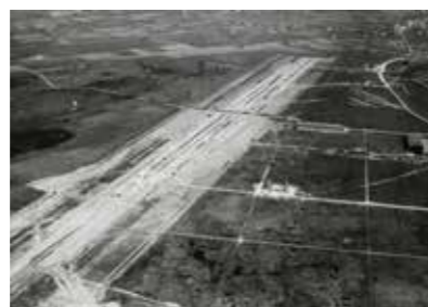
Bald kann der Belag aufgebracht werden: Die Vorarbeiten für den Bau der Piste 28 sind fertig.
