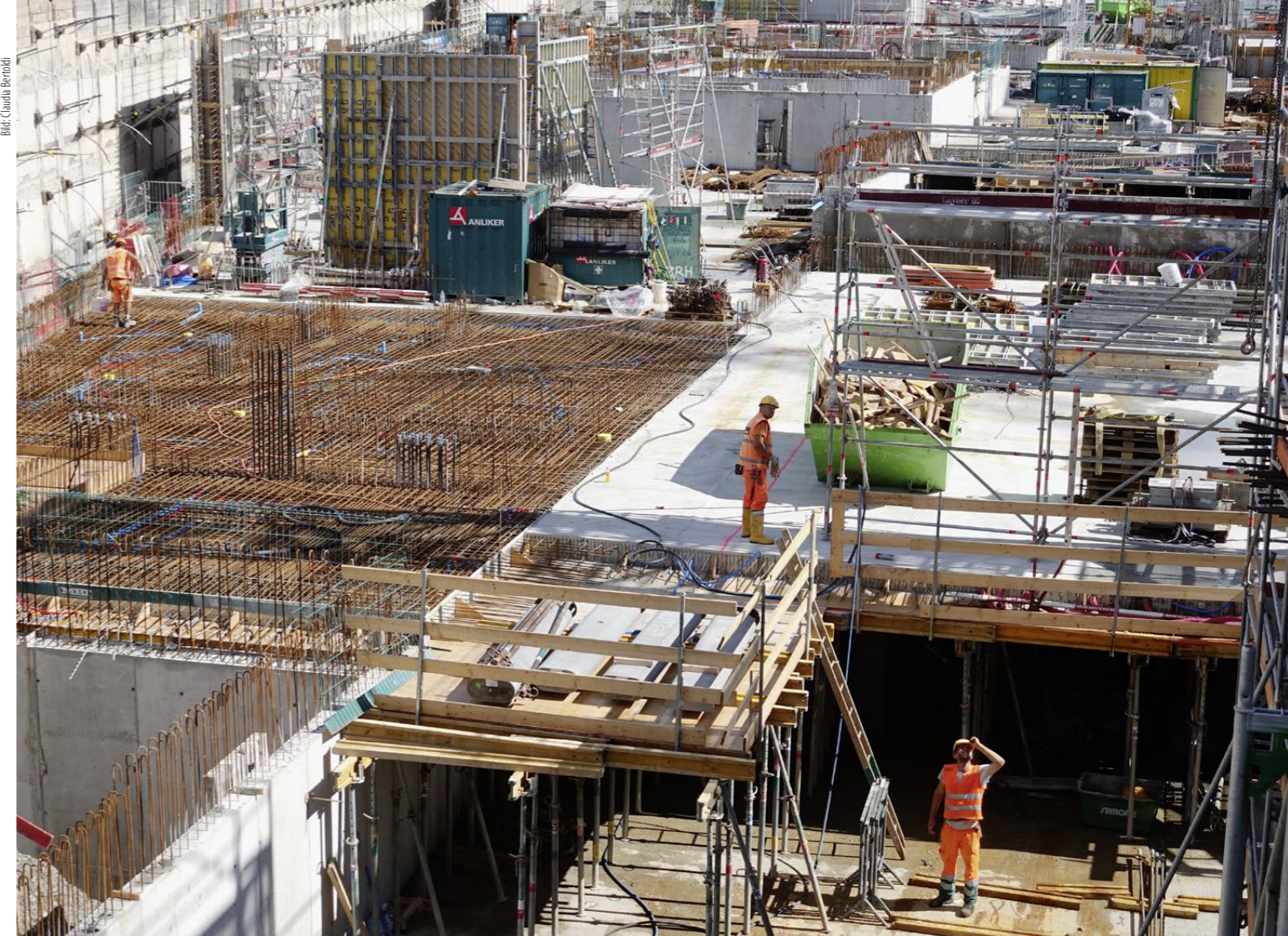
Konjunkturstütze im Grossformat: Ende Juni werden in Bülach die Untergeschosse des künftigen Glasi-Wohnhochhauses betoniert.
